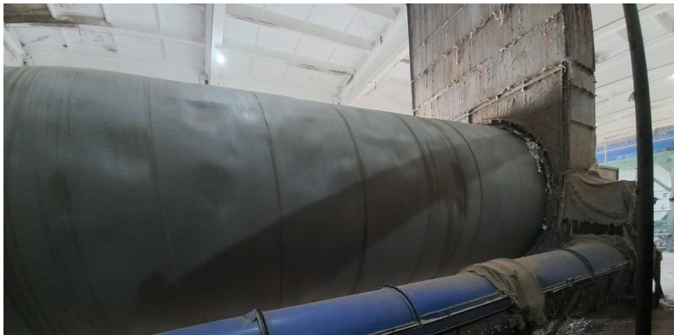
2-rasm. Andijon viloyati Jalaquduq tumanining SAMO MCHJ ga qarashli paxta tozalash zavodidagi paxta quritish barabaninig umumiy ko'rinishi.
